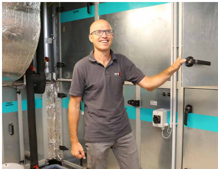
Alexander Pruckner im neuen Lüftungsraum
